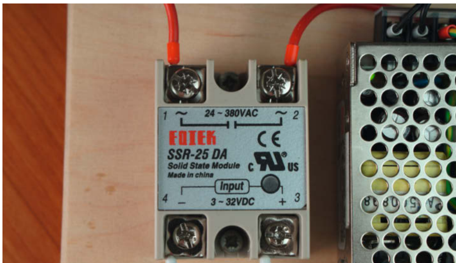
4 Die einzelnen Komponenten (hier das Halbleiter-Relais) wurden mit Schrauben auf der Grundplatte montiert. Die 230V-Anschlüsse (oben) sollten später berührungssicher abgedeckt werden.
