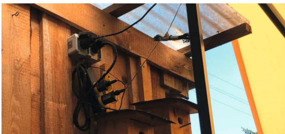
Fast richtig: IP44-Steckdosen wettergeschützt montiert, aber eine offene und lose Mehrfachsteckdose, in die Feuchtigkeit eindringen kann.
