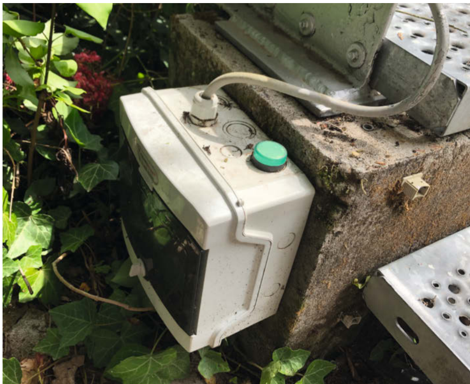
15 Jahre alter Außenverteiler: IP65-Ausführung, wettergeschützt nach Norden ausgerichtet, ohne Sonneneinstrahlung
