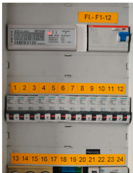
Typischer Sicherungskasten mit Fehlerstrom- und Leitungsschutzschaltern.
