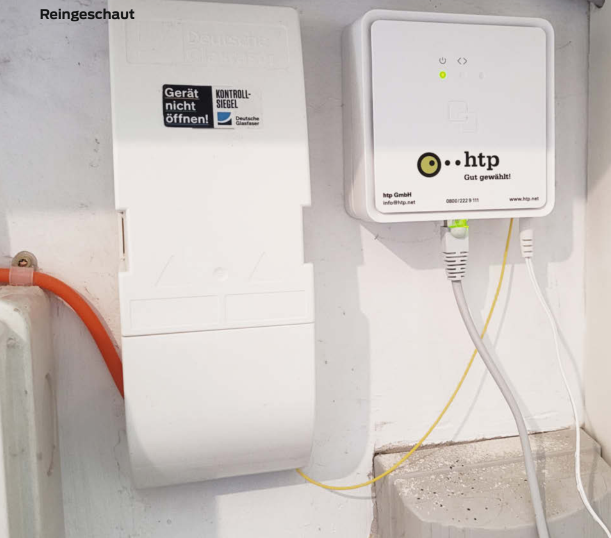
Bild 1: Das Kontroll-siegel hatte der erste Techniker selbst schon gebrochen und nicht wieder erneuert ...
