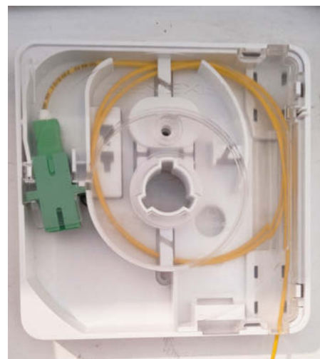
Bild 3: Die Basisplatte des GF-TA dient im Prinzip nur der Aufnahme eines Patchkabels.
